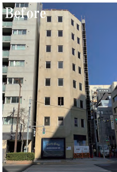
外壁タイルは所々浮きや破損が目立っていた
