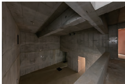
VIPルーム用空間から。天井高が高いのが分かる
