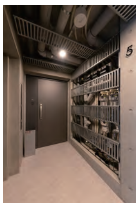
共用部配管やメーターを半分隠す
