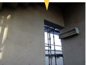
東側 2 階。爆裂箇所へ下地処理を行ってクレン等を行い、不陸補正を施した後、TC工法で補修
