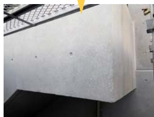
東側。鉄筋が露出し、コンクリートの落屑がひどかった箇所も見事修復、TCコートで美しく仕上がる
