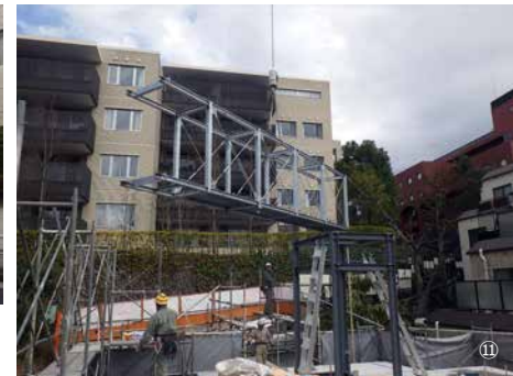
⑪クレーンで吊り下げられたブリッジの設置は1回で行わなくてはならない。緊張が走る
