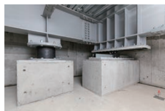
地下の免振装置の一部。建築の第一目的は地震対策
