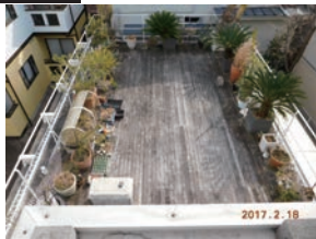
デッキ全体が変色している
