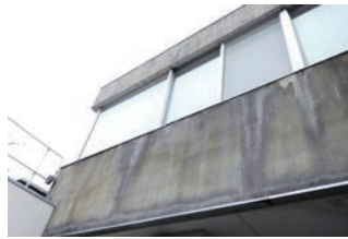
白かった外壁にも雨シミが出ていた
