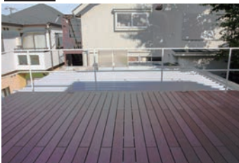
テラスは面積を減らして樹脂木デッキに張り替え、鋼板には遮熱塗料を再塗装
