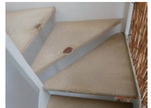
内部階段のカーペットはがれ
