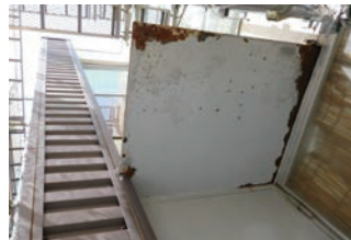
玄関上の底にも錆がかなり出ていた
