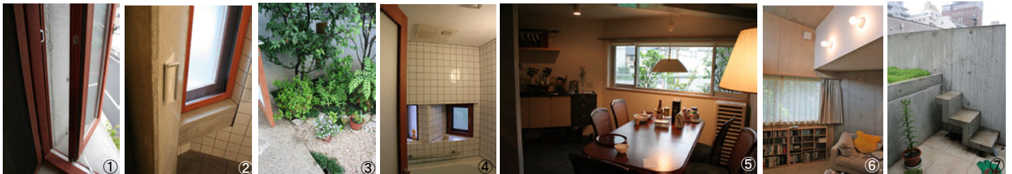
①トイレの木製サッシ窓の左側の外壁部分②戸当たりを兼ねるトイレの開閉クッションの角カバーがはずれてしまう③1階玄関廻りの庭。手前の草むらの穴にコンセントが仕込まれているので、位置を移動④風呂。天井中央にうっすらと黒いシミができた⑤ダイニングテーブルのペンダントライト。斜めにコンクリート打ち放しの梁があるので、少し手前にフックを設ける⑥2階リビング。トップライトのある天井の高い方の明るさが天井の低い方にもほしいので、器具を追加。⑦2階ベランダから庭園へ伸びる階段。一番上の踏み板を補修する。
