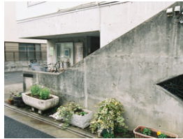
外壁の黒い汚れが目立つ近くの施設
