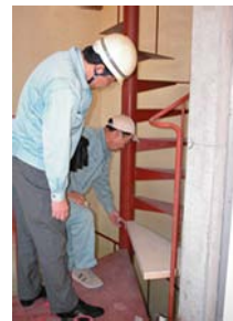
螺旋階段の踏み板のモデルをベニヤで作成してきた大森さん。作業工程を大山専務と相談する。
