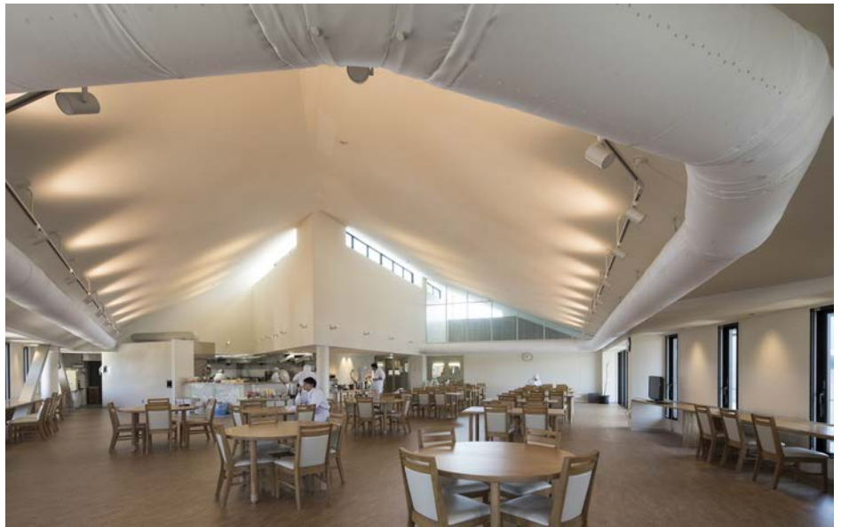
天窓からの光が柔らかいカフェスタイルの食堂。空調設備は布製エアダクトの「DUCTSOX」を採用
