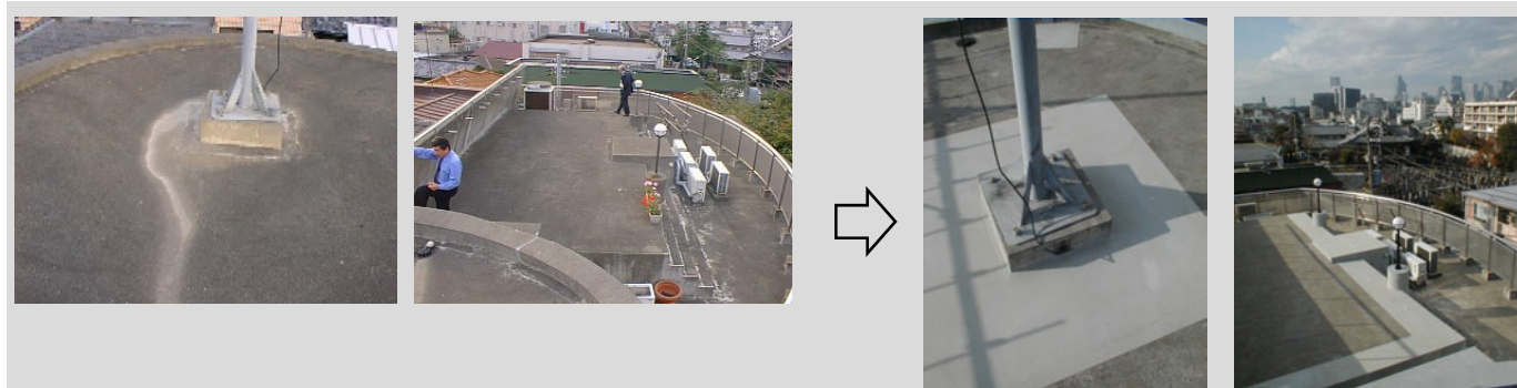
GWビル屋上施工前／ところどころクラックの補修が行われている
