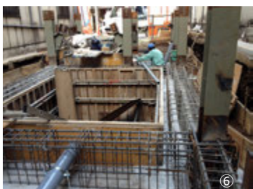
③基礎施工状況。基礎配筋と柱が偏心であることが確認できる
