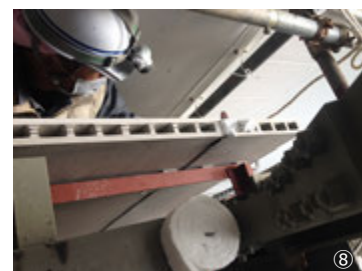
⑧外壁アスロック取付状況。梁にアングルピースを付け足し、敷地いっぱい施工
