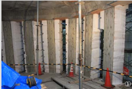
①2階室内から、外周柱を臨む。型枠のスチロールがまだ残っている
