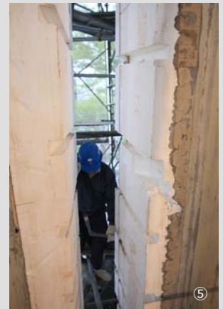
⑤クロム線の熱線を使って、二人がかりで型枠のスチロールを溶かしはがしていく
